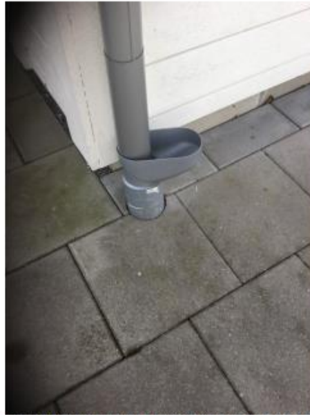
#3 E - Stuprörsanslutningar mark är inte UV beständiga (1/1)
